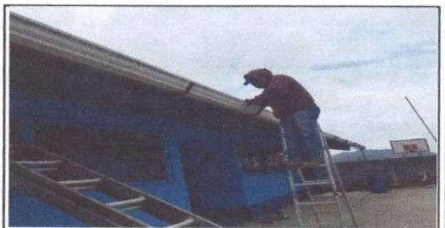
Foto 6: Sustitución de soporte o pescante de metal para canal
